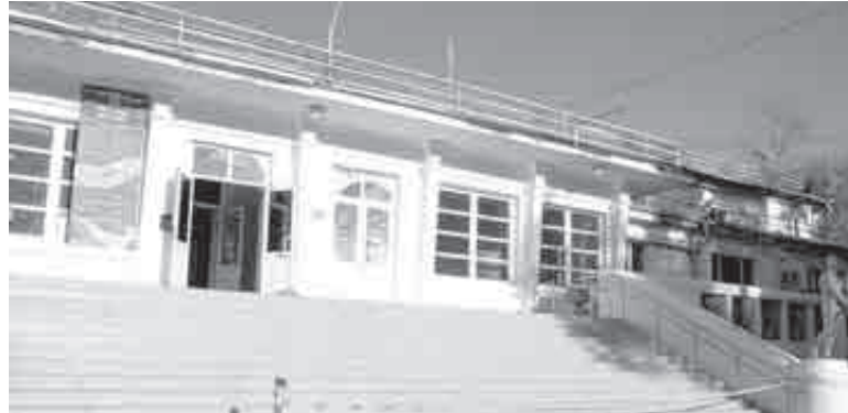
В Минспорта перед самым заседанием отчитались: в Универсальном краевом спорткомплексе Хабаровска в ходе начатой в мае реконструкции отремонтированы раздевалки, коридоры и лестница с южной стороны УКСК. Фото Минспорта края
